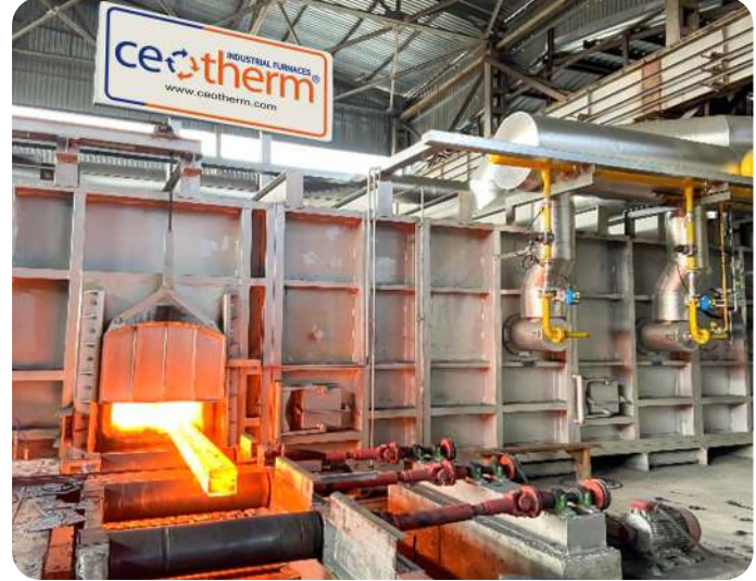
Stell Billet Re-Heating Furnaces / İtmeli Tip Kütük Isıtma Fırını
